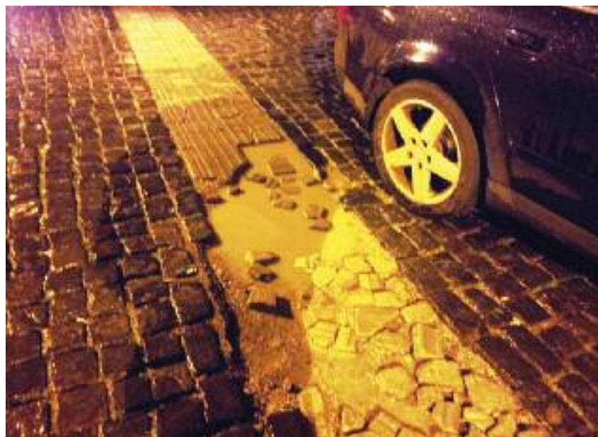
Un particolare della pavimentazione danneggiata.
